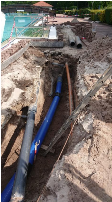
Rohrbruch Freibad Kochsagrund
